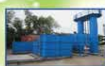
Hệ thống xử lý nước thải
