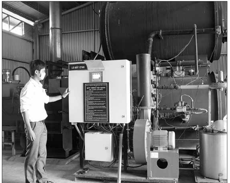
▲ Lò đốt CTNH công suất 200 kg/h
